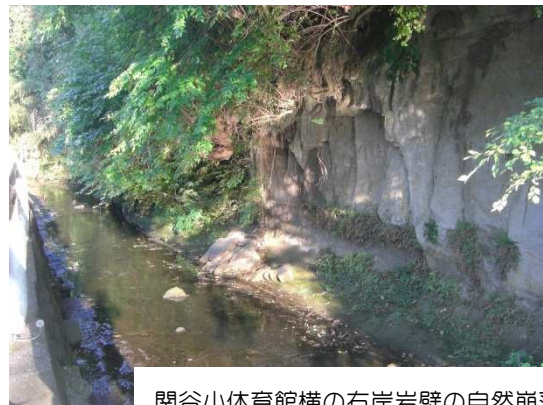
関谷小体育館横の右岸岩壁の自然崩落
