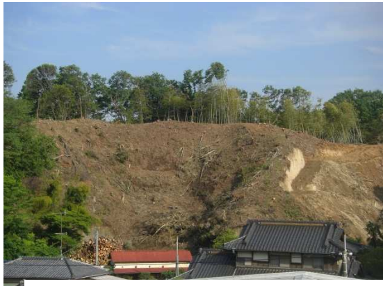
関谷小校庭の対岸で宅造工事進行中 貴重なみどりが消滅してゆく
