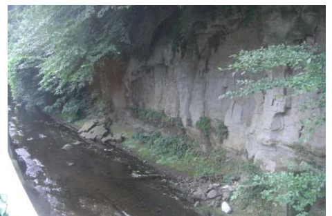
関谷小体育館横の流れの崩落
