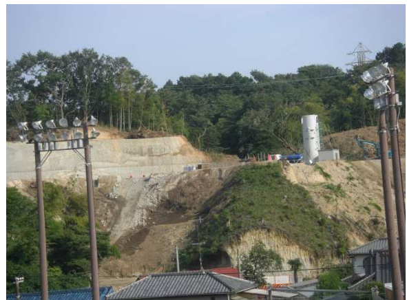
右岸の関谷小校庭向かい斜面で大規模宅地造成が進行中。 保水力喪失で関谷川増水が懸念される。関谷小校舎から撮影(2013.7.28)。両側は校庭の照明塔。手前の住宅は危うく見えるが、大丈夫なのか。
